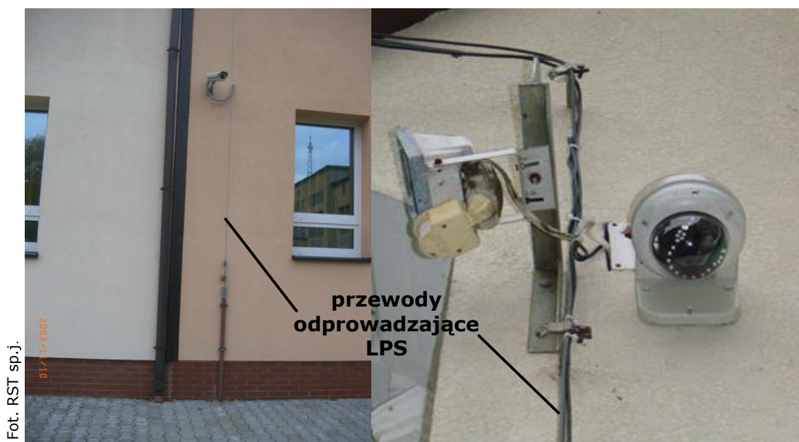
Rys. 1. Błędy przy montażu kamer systemu CCTV: niezachowanie bezpiecznych odstępów izolacyjnych i prowadzenie kabli wzdłuż przewodu odprowadzającego instalacji odgromowej
